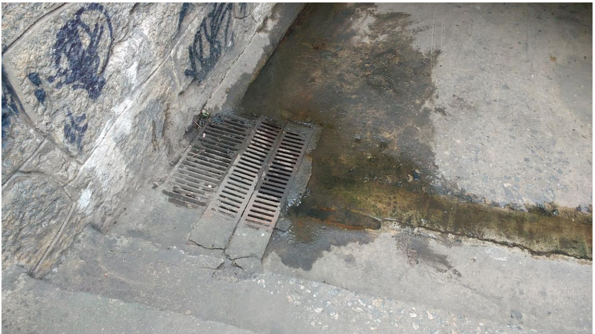
(1) Travessia em direção à Rua Goiás. (2) Infraestrutura precária. Foto: acervo pessoal.
