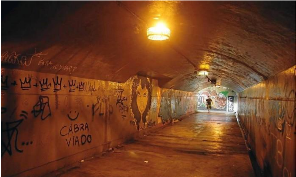
Passagem subterrânea do Encantado, localizada na Rua Goiás, Encantado, Rio de Janeiro. Fonte: O Globo.
