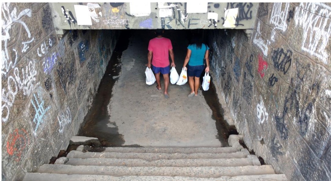
Pichações, acúmulo de água e outras patologias. Foto: acervo pessoal.
